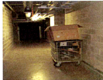
Waste left in Corridors 垃圾停放在走廊(过道) Śmieci pozostawione na korytarzu
