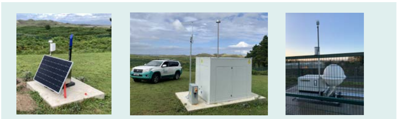
Fíor 13. Trealamh suiteáilte mar chuid d'uasghrádú an Líonra
